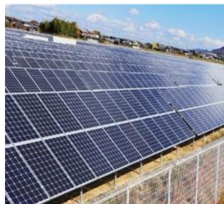
自社太陽光発電所
